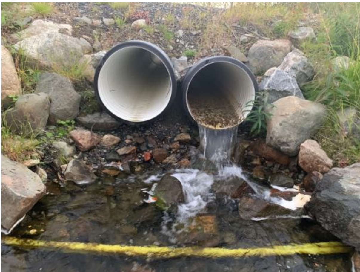
Figur 3. Bekk fra Rabbvannet er lagt i rør og er potensielt vandringshinder for ørret. Det bør gjennomføres tiltak for forbedring.
